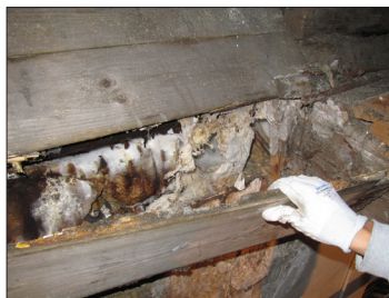
Hausschwamm hinter Holzverkleidung
